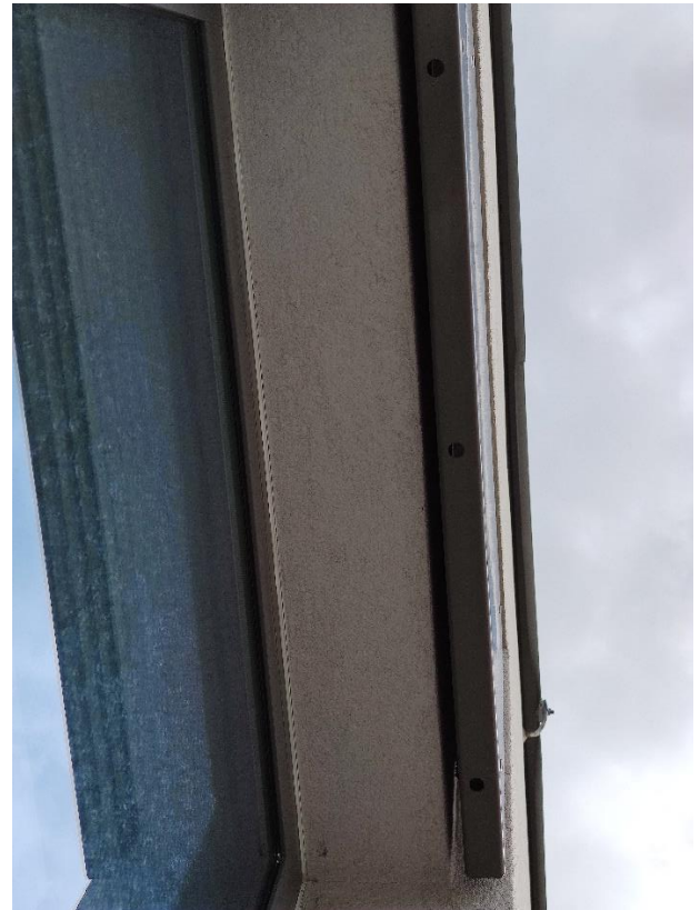
Spalten oberhalb der Fenster (eigene Aufnahme 02.04.2024)
