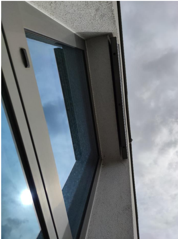
Spalten oberhalb der Fenster (eigene Aufnahme 02.04.2024)
