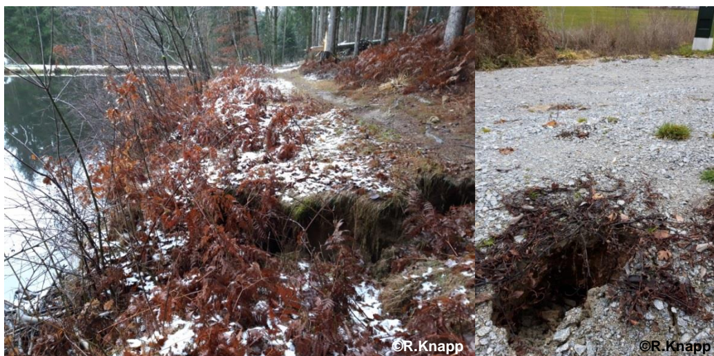
Eingebrochene Biberröhre unter Weg entlang eines Fischteiches (Links) und unter einer Schotterstraße (Rechts)
