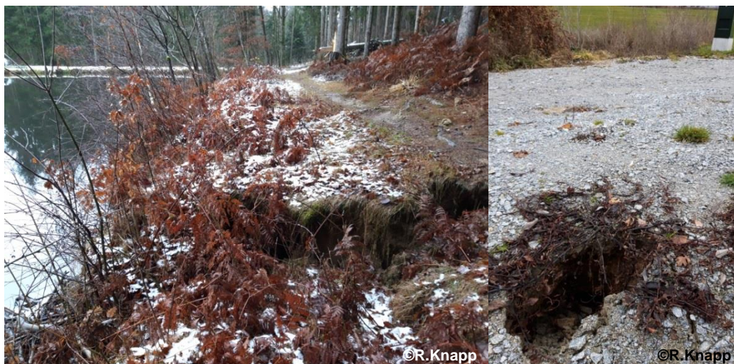
Eingebrochene Biberröhre unter Weg entlang eines Fischteiches (Links) und unter einer Schotterstraße (Rechts)
