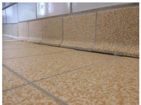
Hohlkehlen-Fliese FALSCH verlegt (stehend). Wasser kann bei undichter Silikon-Fuge in die Mauer eindringen
